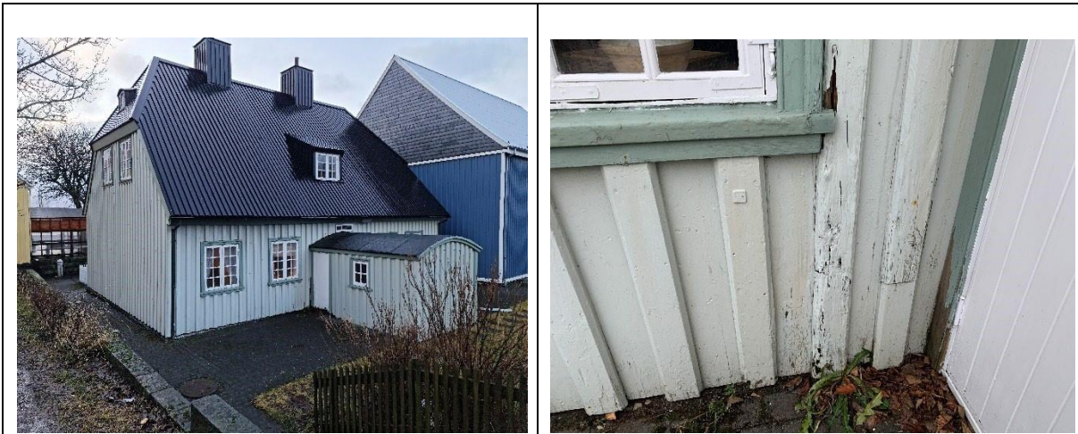
Myndir. Endurnýja þarf útveggjaklæðningu á norðurhlíð vegna fúa.
