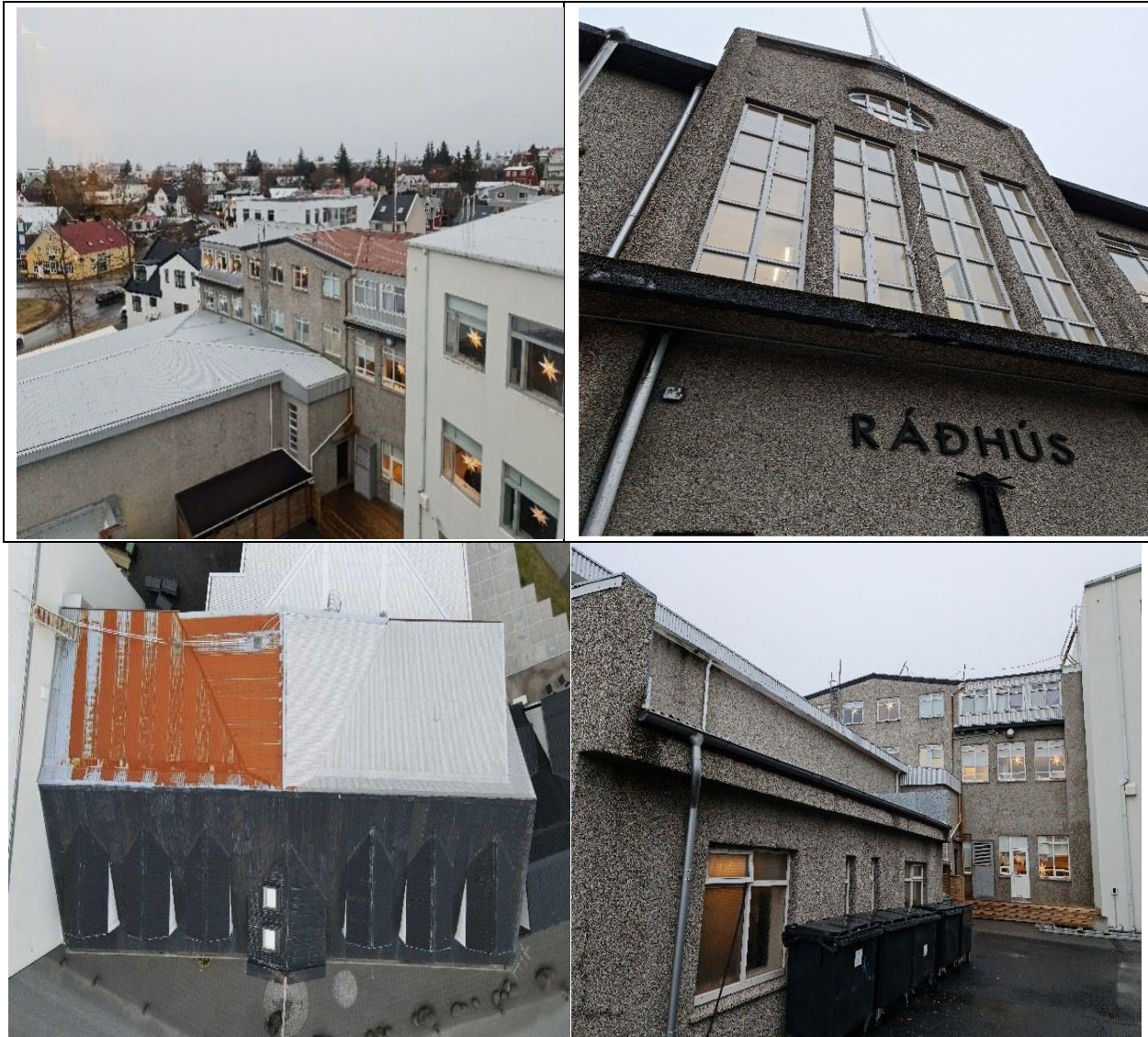
Myndir. Endurnýja þarf þakklæðningu. Yfirfara þarf glugga á bakhlíð vegna leka inn í bygginguna. Einnig þarf að yfirfara rennu á útbyggingu.
