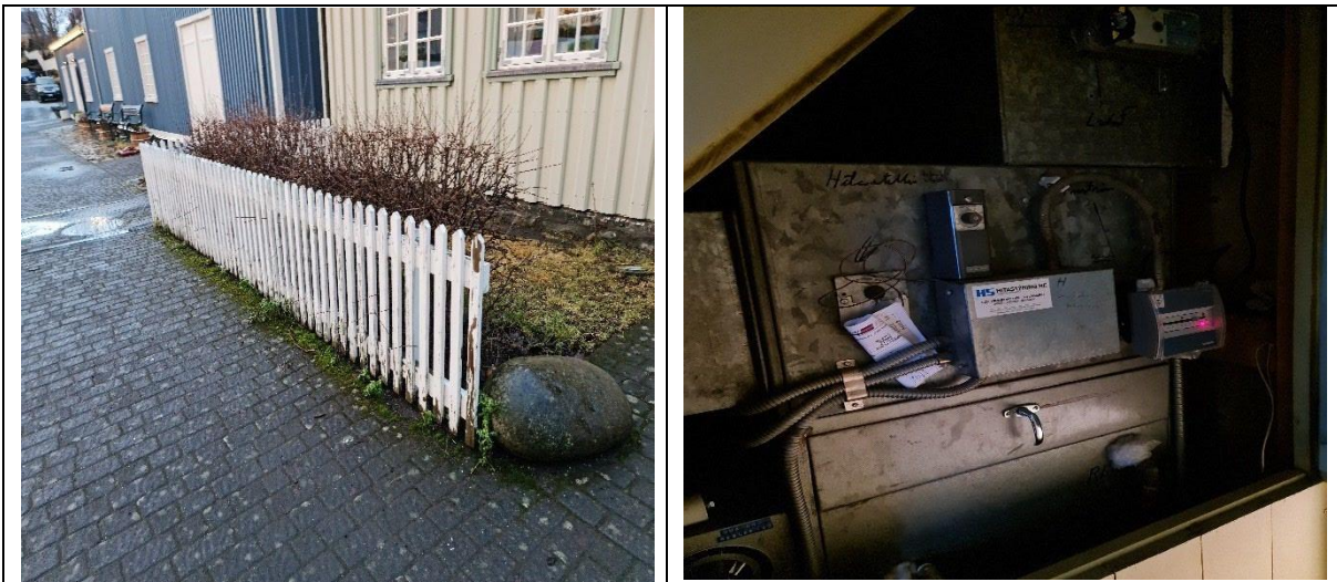
Myndir. Endurmála þarf grindverk framan við hús. Yfirfara þarf loftræsisamstæðu, virkar ekki sem skyldi.
