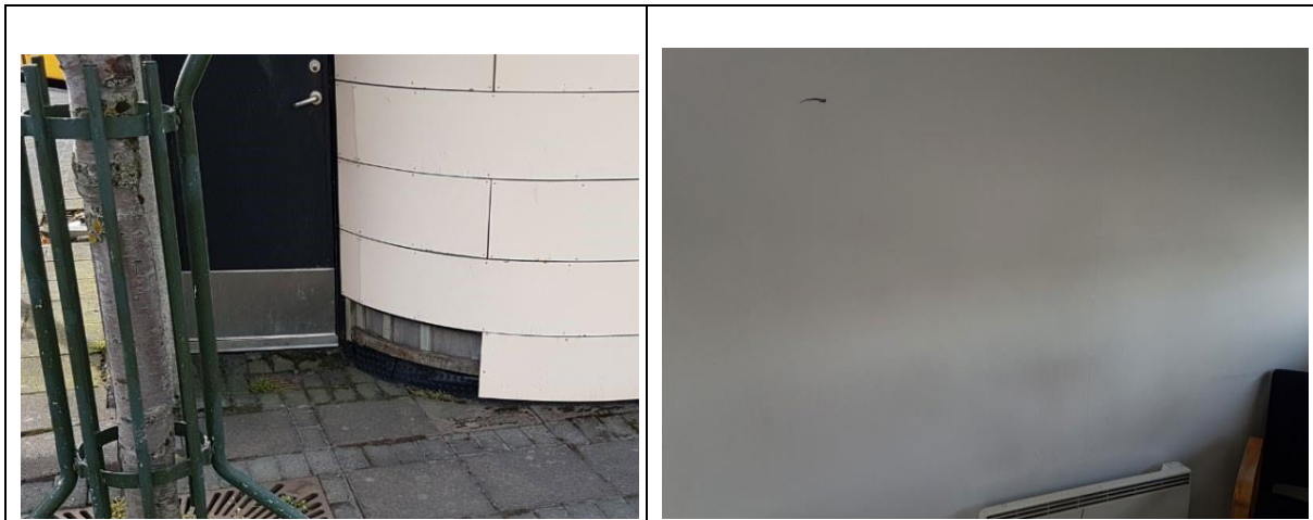
Myndir. Þarf að lagfæra klæðningu. Endurmála þarf vegg innanhúss.
