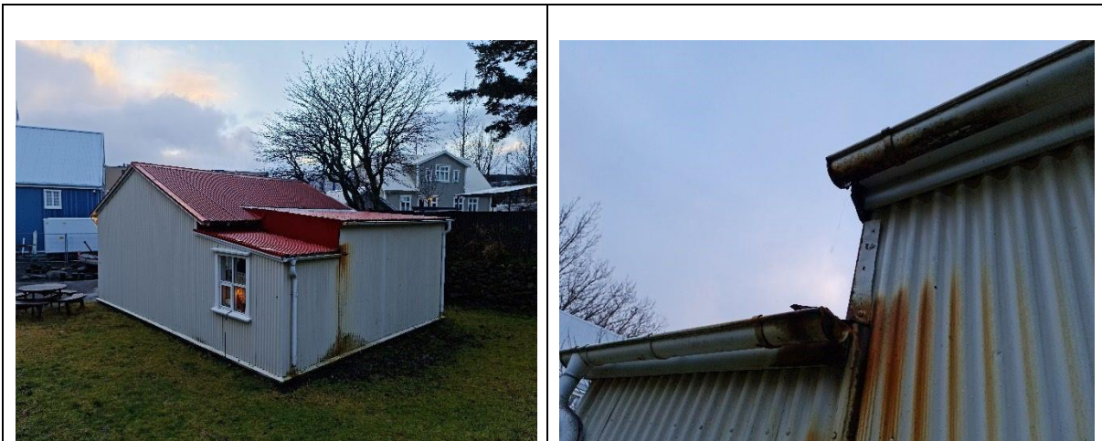
Myndir. Endurmála þarf útveggjakklaðningu. Lagfæra þarf frágang á þaki viðbyggingar vegna leka.
