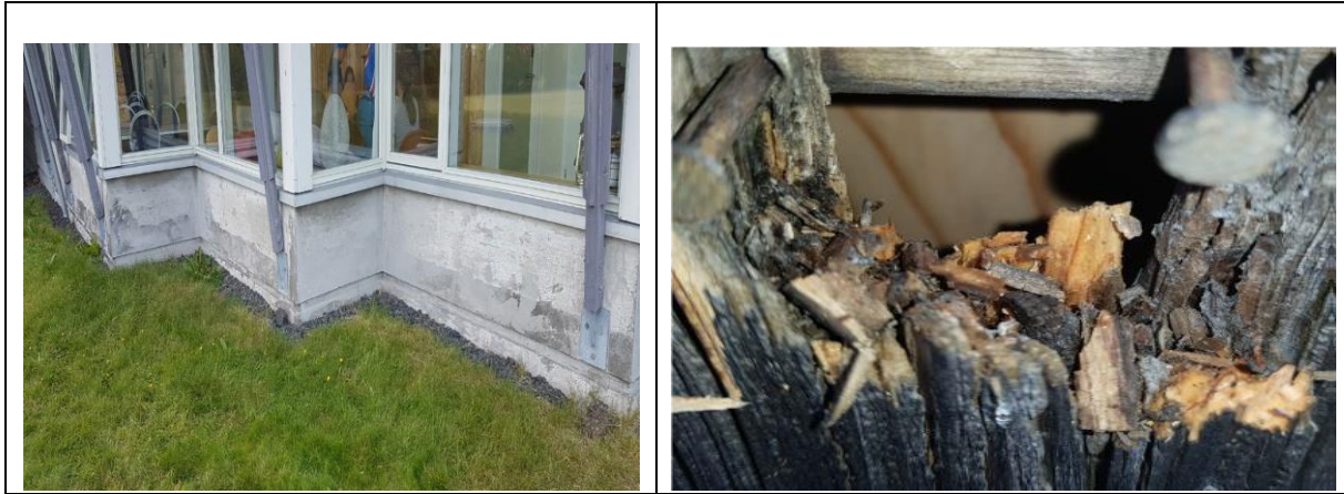
Myndir. Þarf að endurnýja útveggjaklæðningu.
