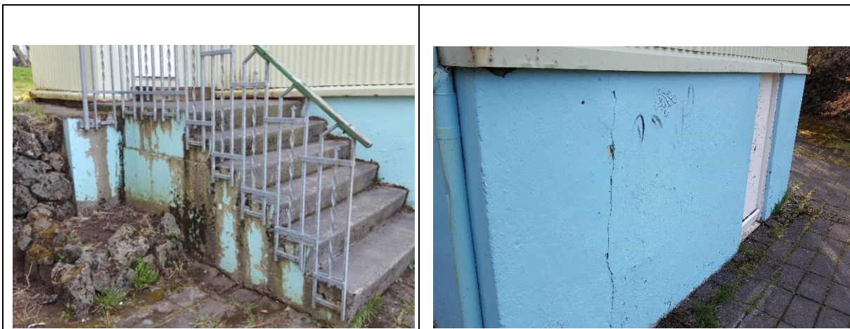
Myndir. Gera þarf við steypuskemmdir.
