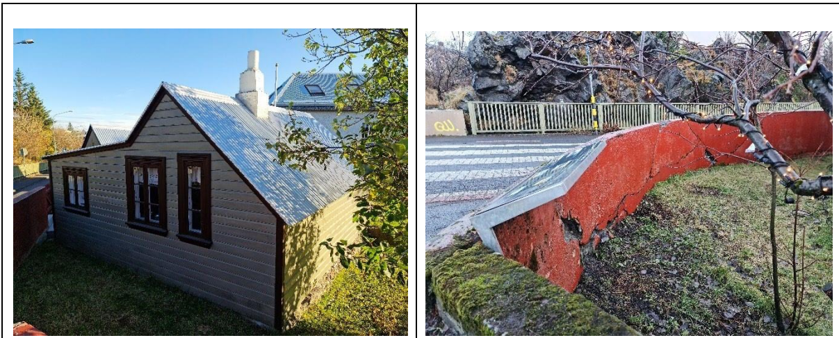
Myndir. Endurmála þarf skorstein. Endursteypa þarf stoðvegg að hluta og mála.
