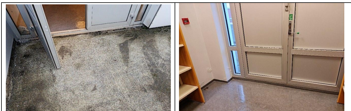
Myndir. Steypt gólf utanhúss er hærra en gólf 2. hæðar, rakaskemmdir innanhúss við neyðarhurð eru líklega vegna þessa.
